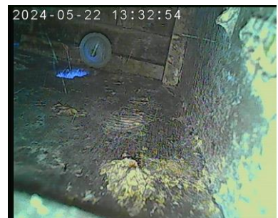
22.05.2024 13:32 Uhr: An der Decke des Hornissenkastens haben Wespen oder Hornissen ein Nest gebaut
